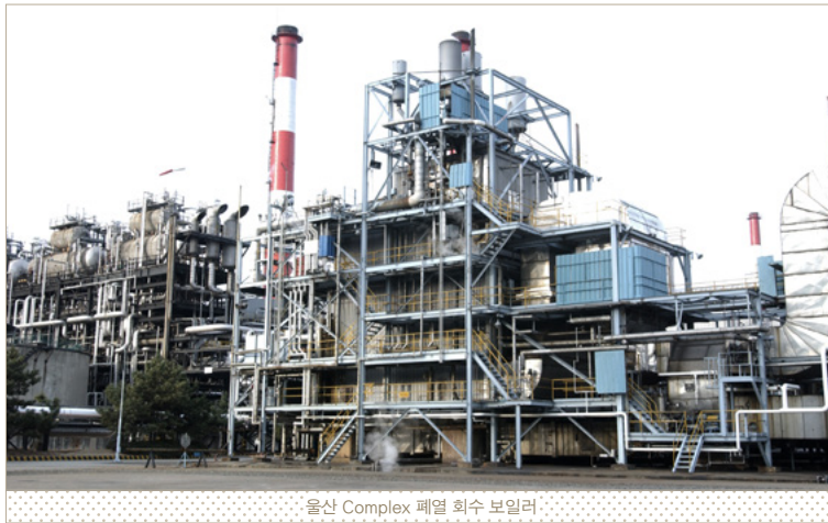
울산 Complex 폐열 회수 보일러
