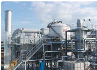
III 사진 14_ 축열식 소각로 (RTO: Regenerative Thermal Oxidizer)
