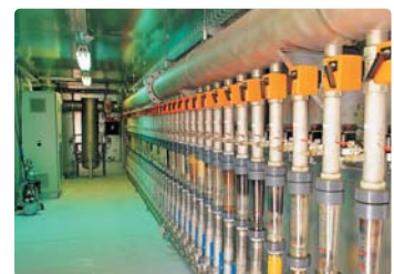
III 사진 26_성암 매립장 LFG 채취실
