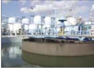
Fig 19. SK 울산 CLX 재폐수처리장 전경
